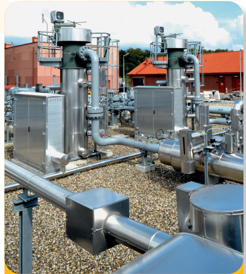
Afb. 6: Bovengrondse leidingen van de cavernes van Trianel GmbH, Gronau-Epe
