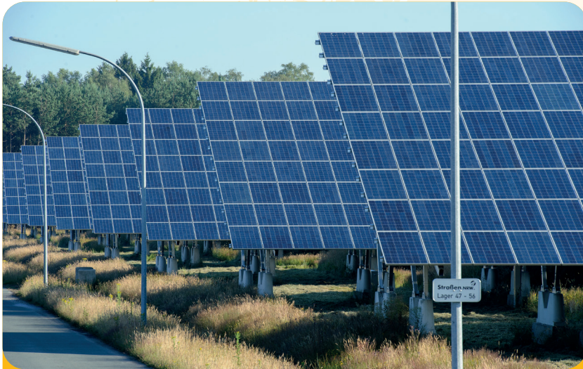
Afb. 5: Zonnepanelen, Saerbeck Bio-energiepark
